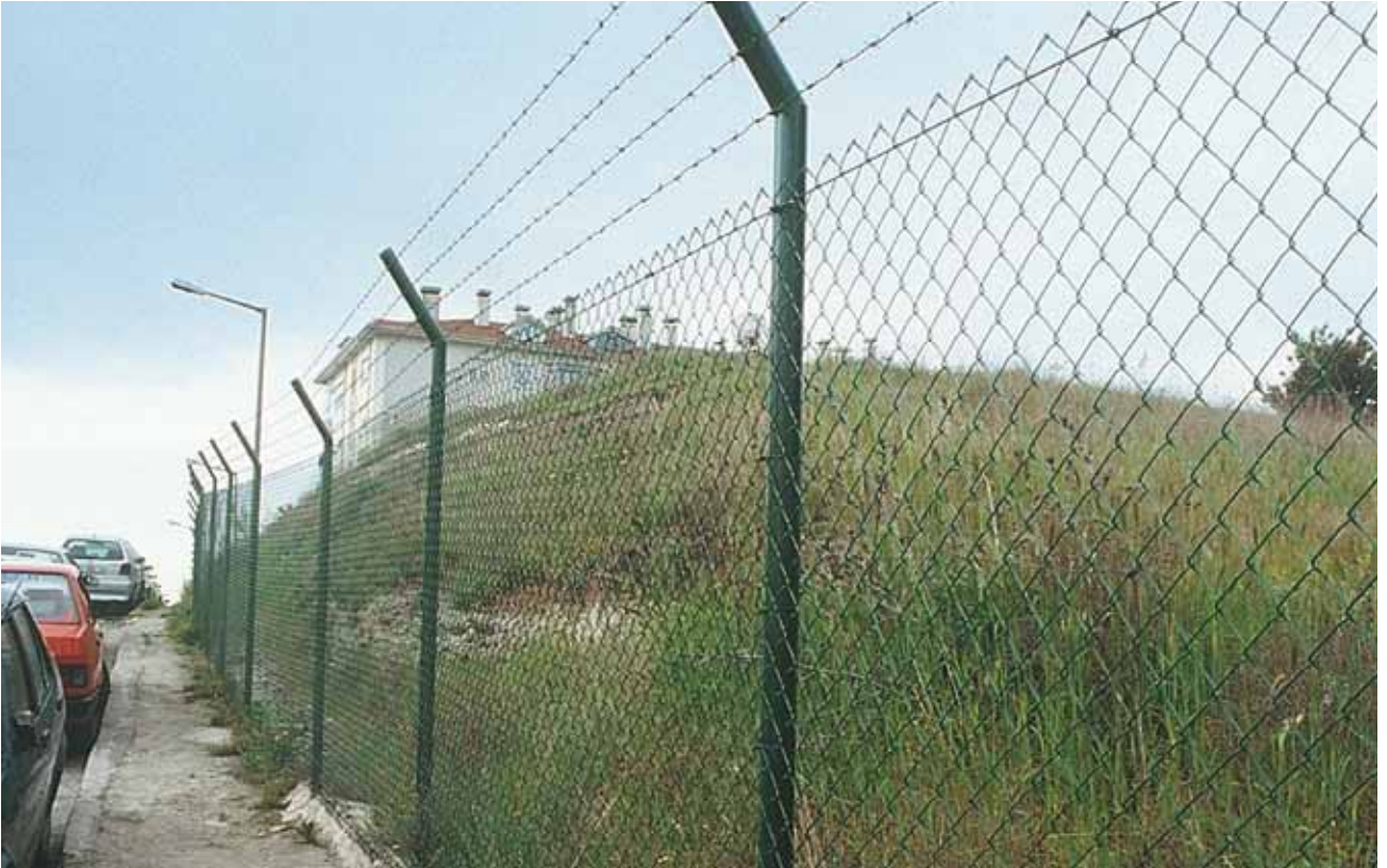
50x50x3 mm galvaniz üzeri PVC kaplı örgü tel üzerine üç sıra dikenli tel uygulaması. 50x50x3 mm Galvanized and PVC coated chainlink fence with three rows of asbarbed wires.
